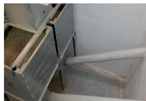
Billede 4. 2-delt fodringsanlæg
