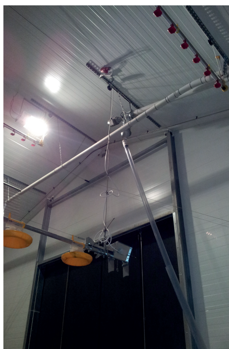
Billede 4. 2-delt fodringsanlæg
